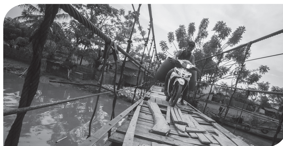
JEMBATAN GANTUNG RUSAK DI TANARA
